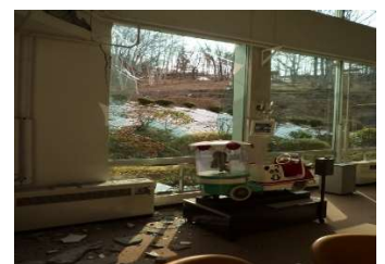
船橋綜合福利中心的玻璃窗破裂，碎片散落
